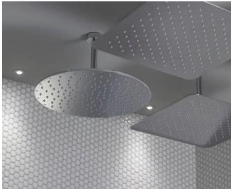
Photo: détail de trois des quatre formats de la pomme de douche. Installées au plafond.
