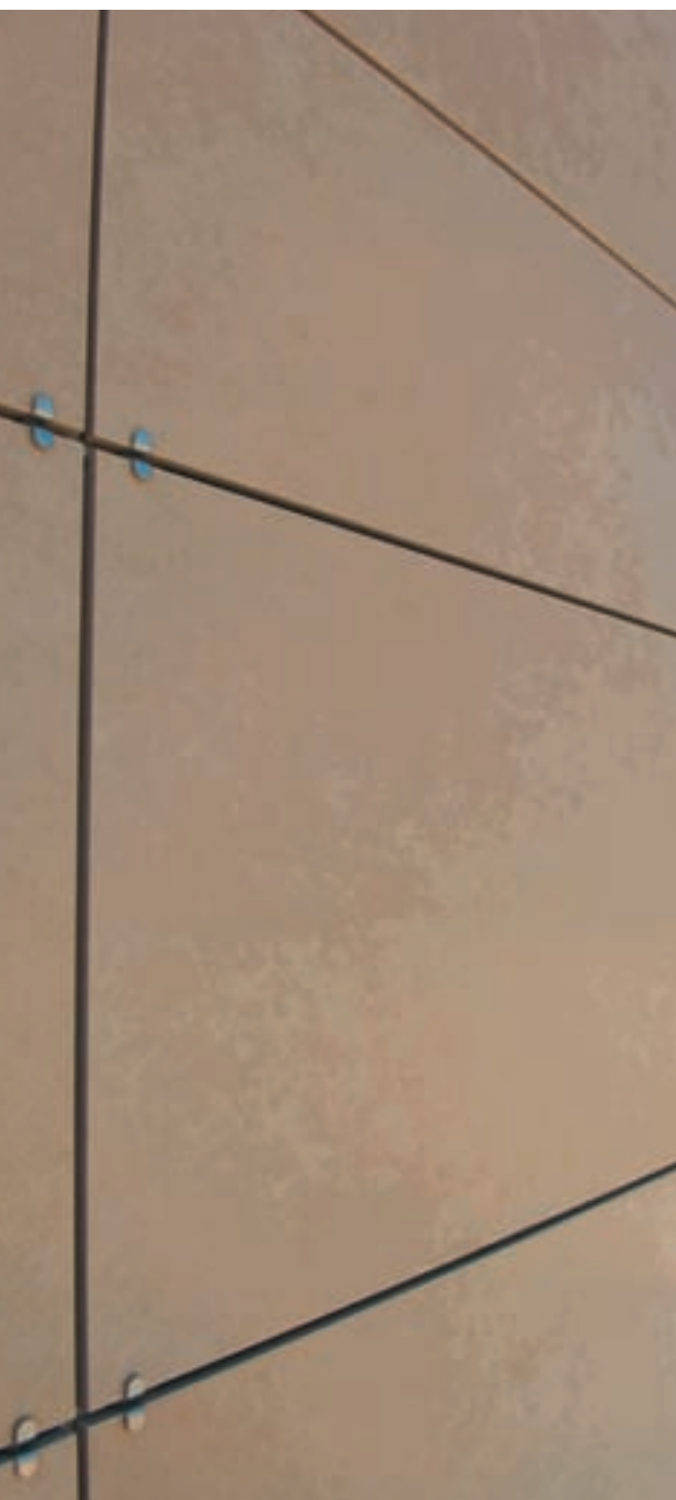
proyecto/project: edificio de oficinas ciudad/country: palma de mallorca producto/product: homestone
