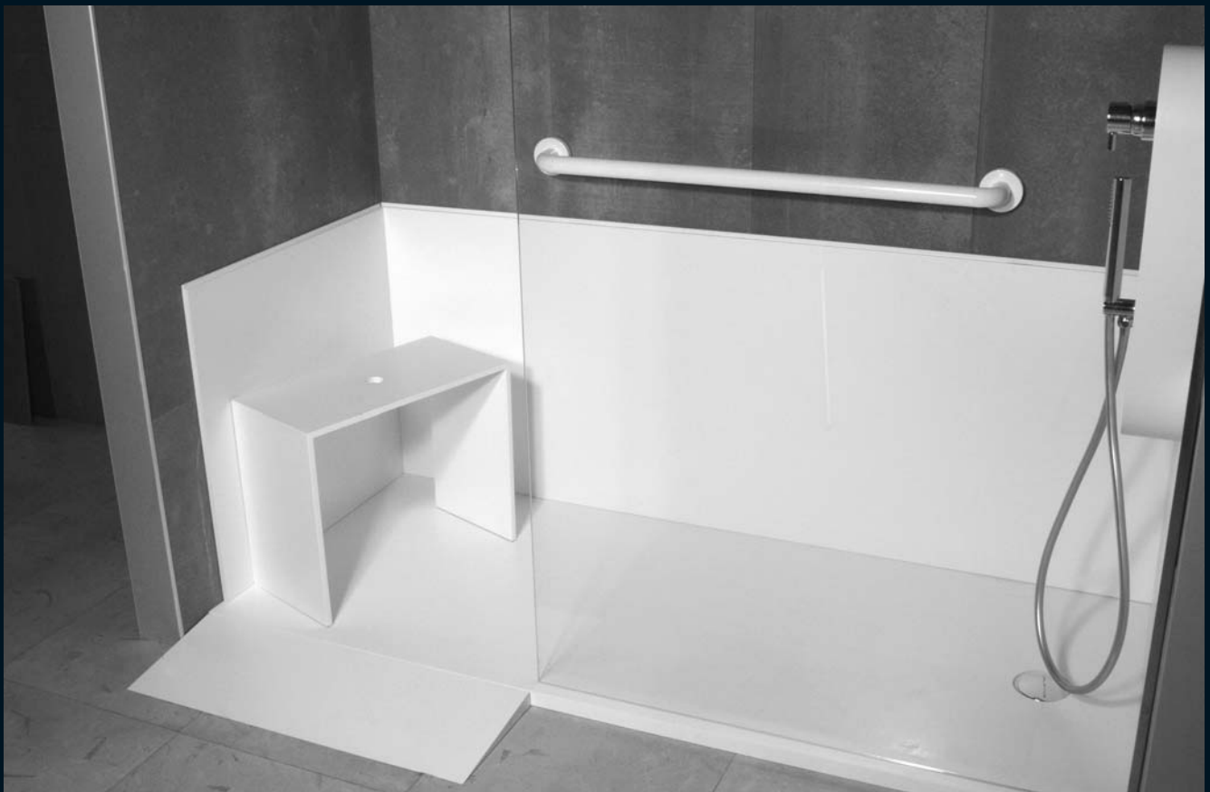
rampa DCPS con asidero largo y taburete
